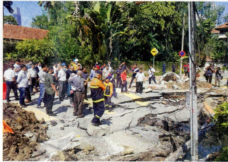
DBKL dan agensi yang terlibat melakukan tinjauan ke kawasan mendapan di Jalan U Thant baru-baru ini.
