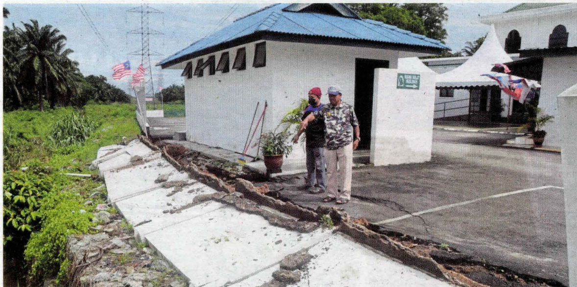
Tembok konkrit pagar Masjid al Ehsan roboh akibat aliran arus deras anak sungai di Kampung Londang, Masjid Tanah, semalam.
