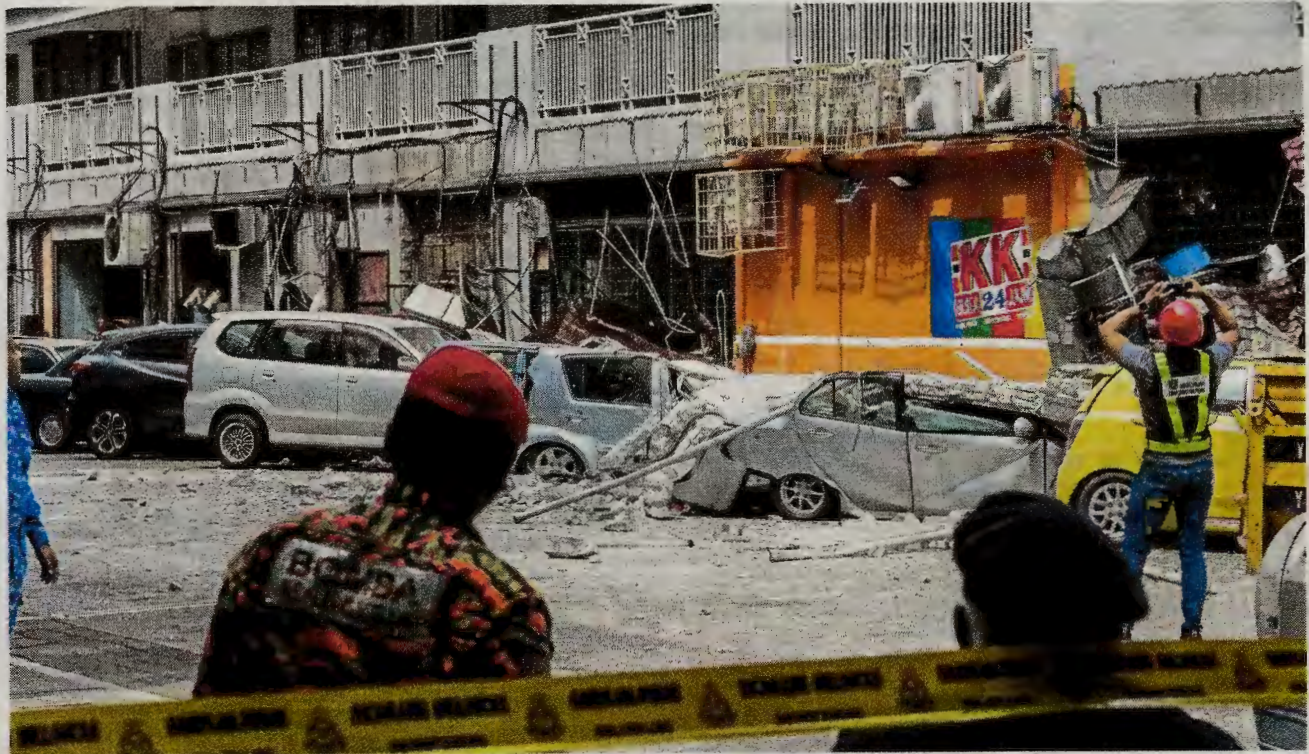
SEKURANG-KURANGNYA 10 kenderaan rosak ekoran struktur rasuk pada bumbung sebuah bangunan komersial lima tingkat runtuh mendadak dalam kejadian di Jalan Kuchai Lama, semalam. - Gambar NSTP/HAZREEN MOHAMAD
