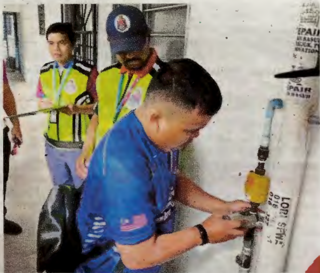
TINDAKAN mengunci meter air rumah penyewa yang mempunyai tunggakan sewa tak dilunas.
