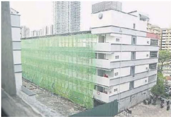
■終獲得授權，開始施工修復。（圖取自《星報》） 斯里帝沙鴻圖園A座建築物坍塌事故，經由多月后
