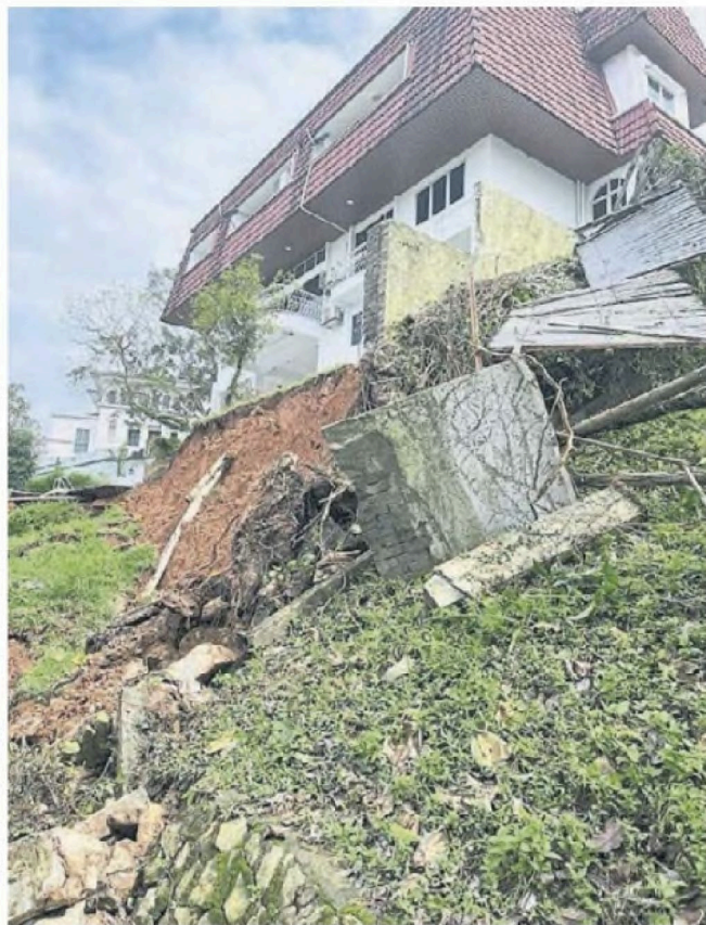
■疑上方豪宅的泳池排水道破漏，崩泻的山泥冲毁邻居家围墙。
