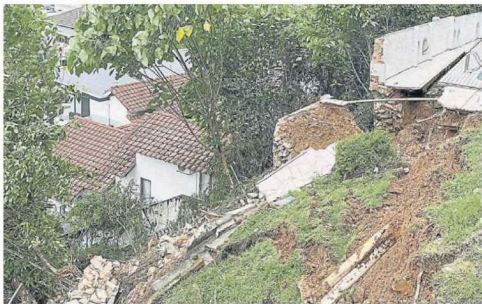
疑上层房屋游泳池排水管漏水酿土崩。(图由消防局提供)
