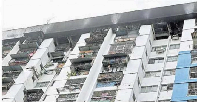
■第17楼楼层屋顶外观，留下严重熏黑痕迹。
