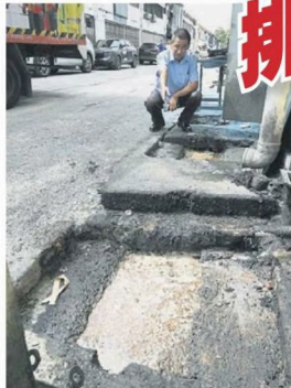
■余保凭指后巷沟渠狭窄老旧，无法疏通大量排水，呼吁阿南弗拉员工清理及疏通沟渠，并希望市政局拨款提升沟渠设施。
