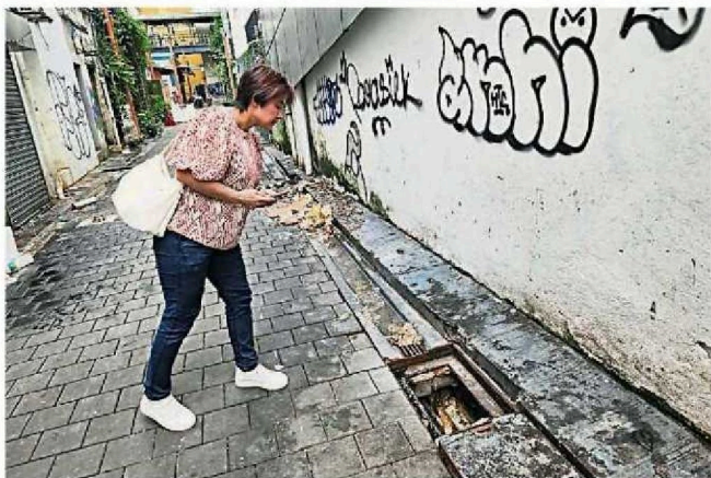
梁愛君巡視巷子的溝渠阻塞問題。(梁愛君提供)
