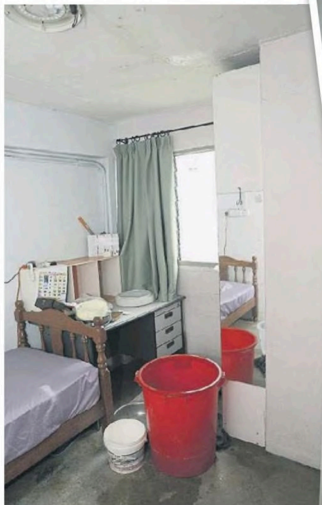
■卧室至今还在漏水，天花板有明显水珠。
