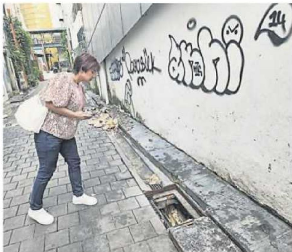
沟渠被垃圾严重堵塞。
