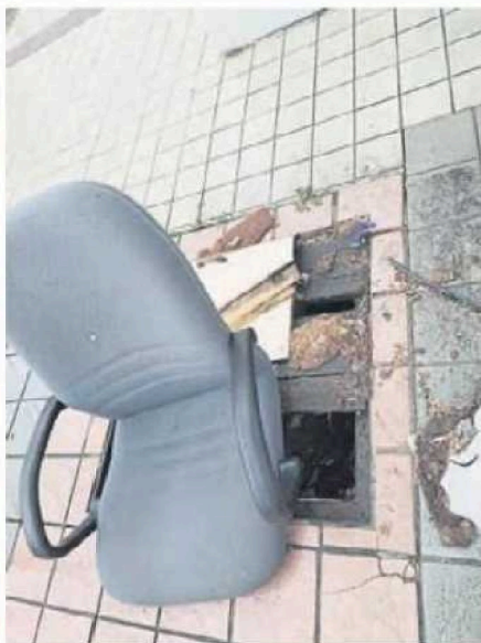
一张已破损的椅子掩盖在已破损的沟渠盖上。
