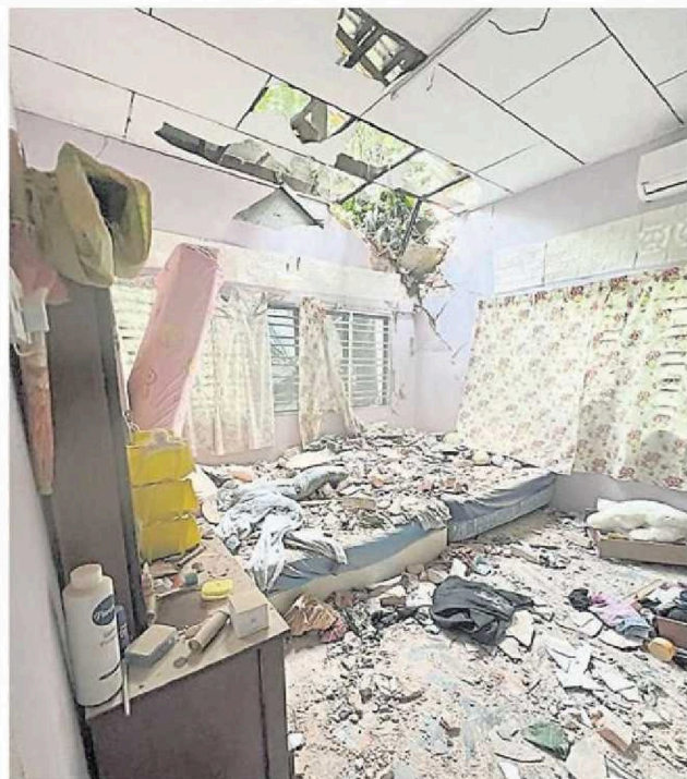
■位于六哩村17路的1间民宅因多处龟裂，已变“危楼”后，居民已暂时搬离该处。（蔡珍莉提供）
