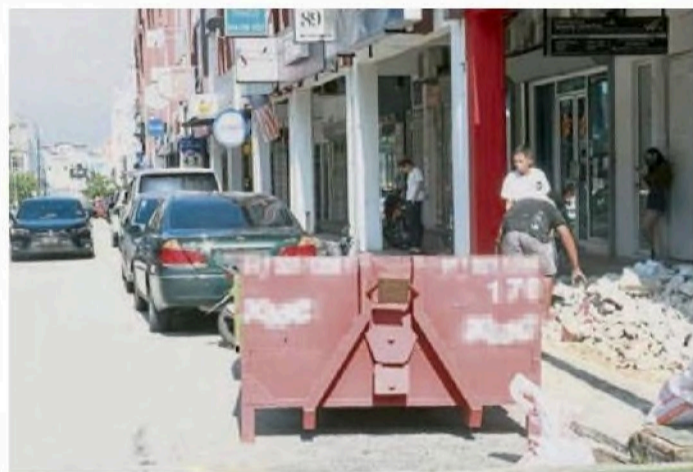
■正在进行装修工程的店家,将垃圾槽摆在泊车位处。
