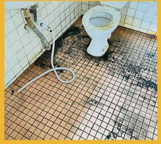
武吉绍加纳公寓面对排污系统阻塞，粪水倒灌问题。（管委会提供）
