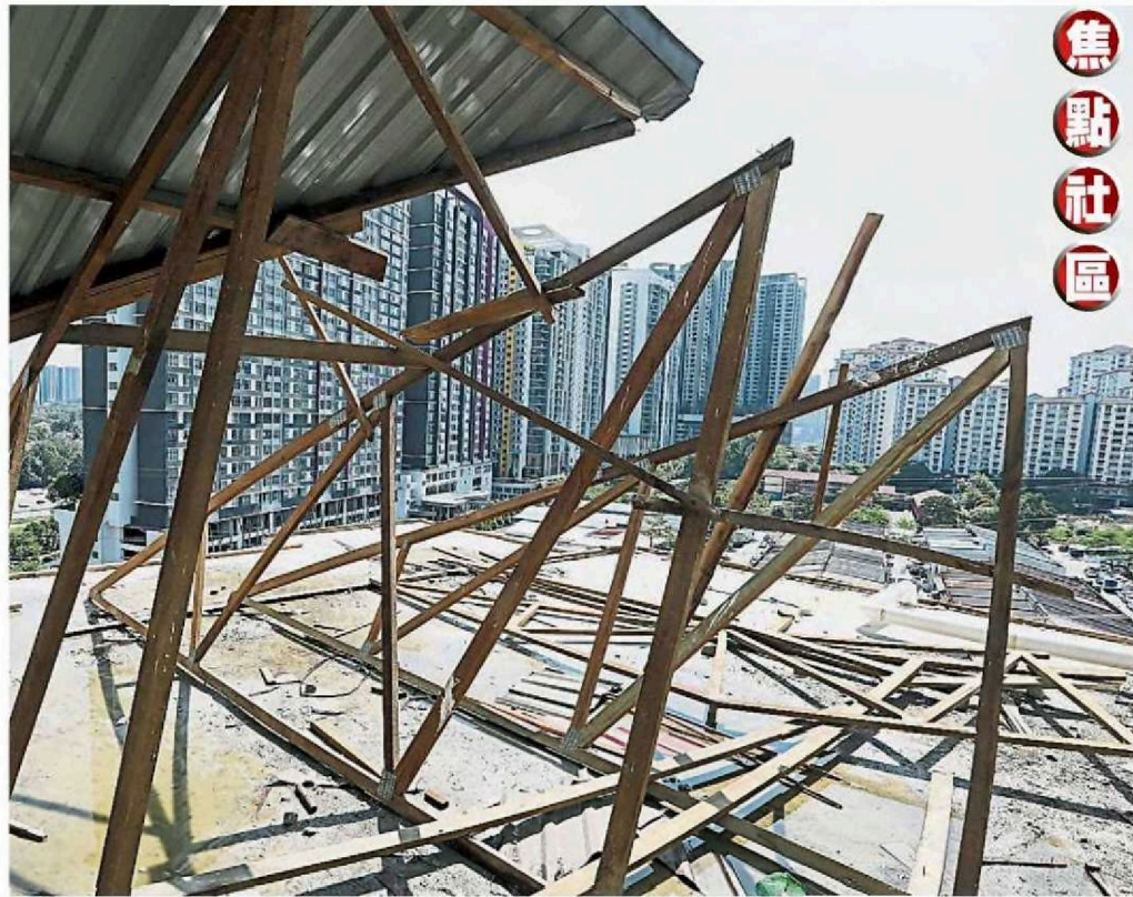
亲善村人民组屋C座楼层屋顶现场一片狼藉。(辛柄耀摄)
