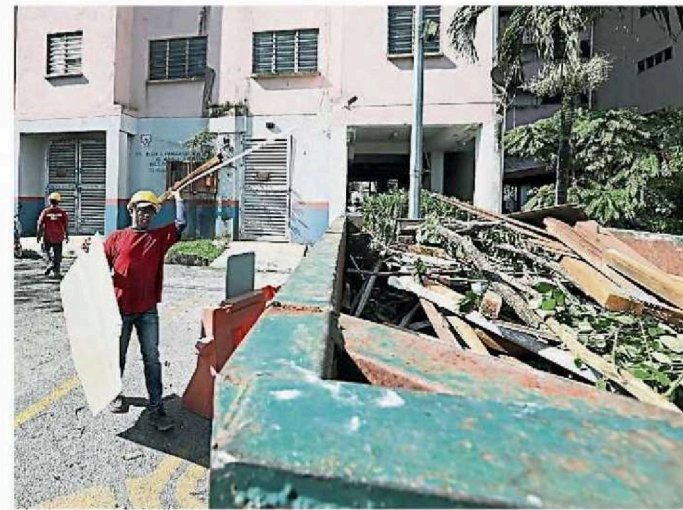
市政局派员前往甘榜亲善村人民组屋进行清理工作,将道路上的树枝、木板清走。(辛柄耀摄)
