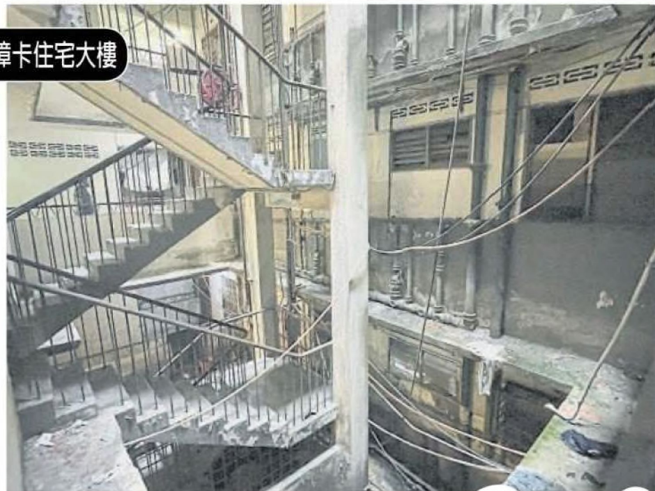
■“上海灘”大樓內脏乱不堪，布满垃圾及随意安装水管，甚至散发难闻味道。
