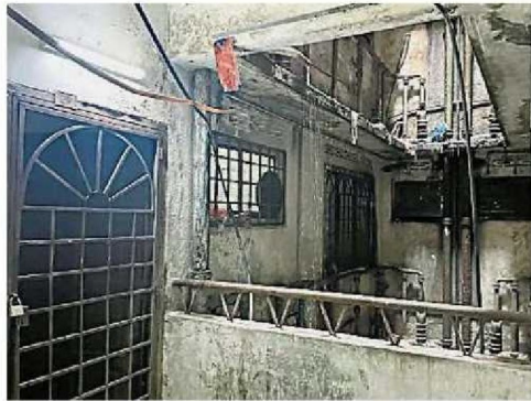
大楼内问题一箩箩，其中包括严重漏水问题。
