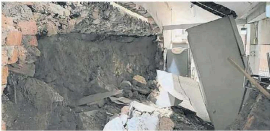
■ 毀，形成一个大窟窿。 山泥严重倾泻，造成一大片墙壁被冲
