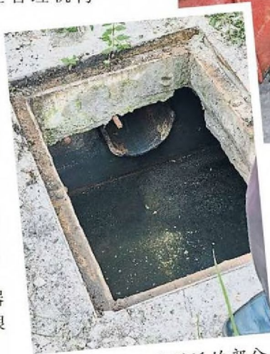
增江捷运站附近的部分沟渠有沙石沉淀，导致沟渠的排水可容量减少。（鍾宝忆摄）
