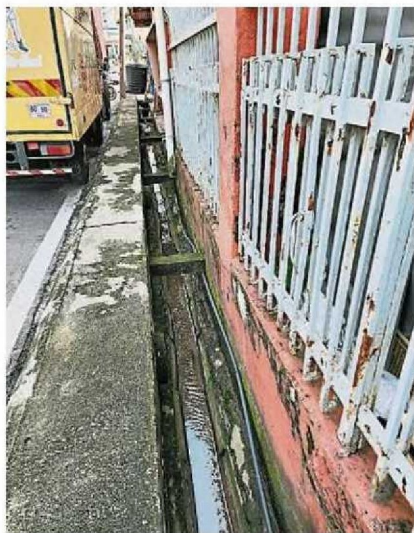
增江北区的西区工业区附近蓬勃发展，沟渠也因发展变得不同大小，宽窄不一，导致一些沟渠无法负荷现今的排水量。（鍾宝忆摄）
