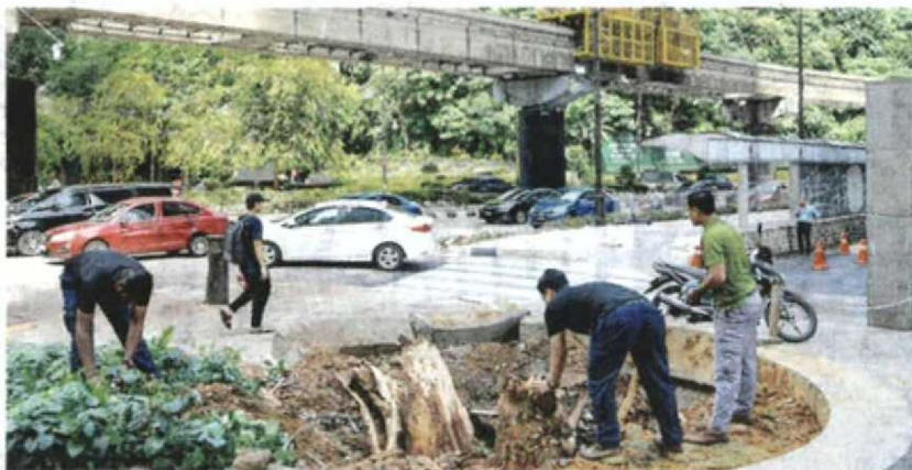
Kerja pembersihan dan membaik pulih dijalankan di lokasi pokok tumbang di Jalan Sultan Ismail pada Rabu.
