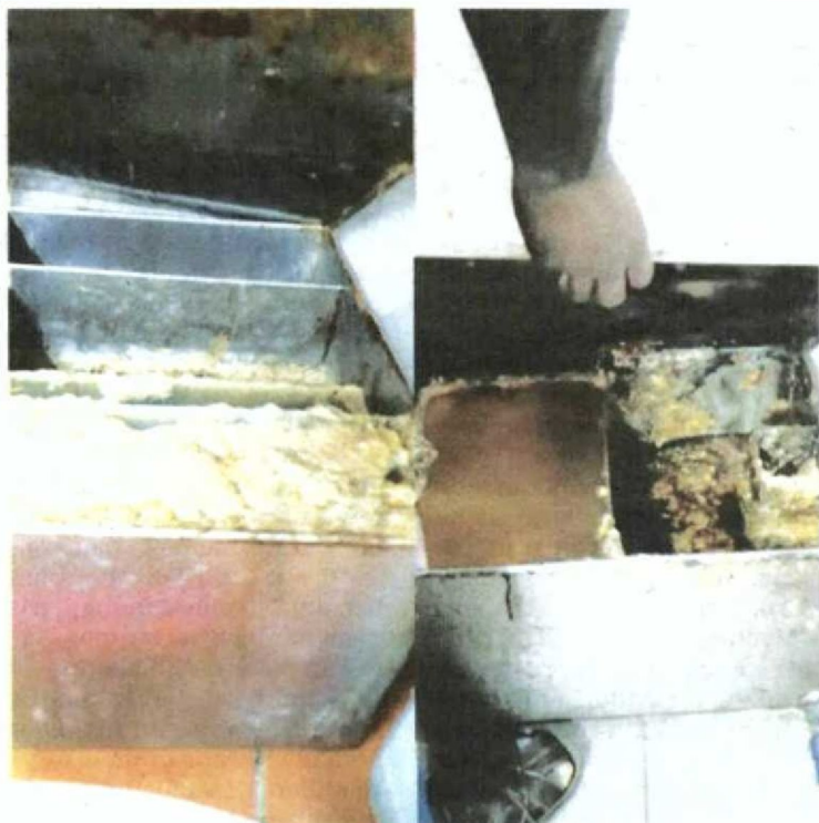
KEADAAN perangkap sisa buangan yang tidak diselenggara di sebuah restoran di Kuala Lumpur baru-baru ini.
