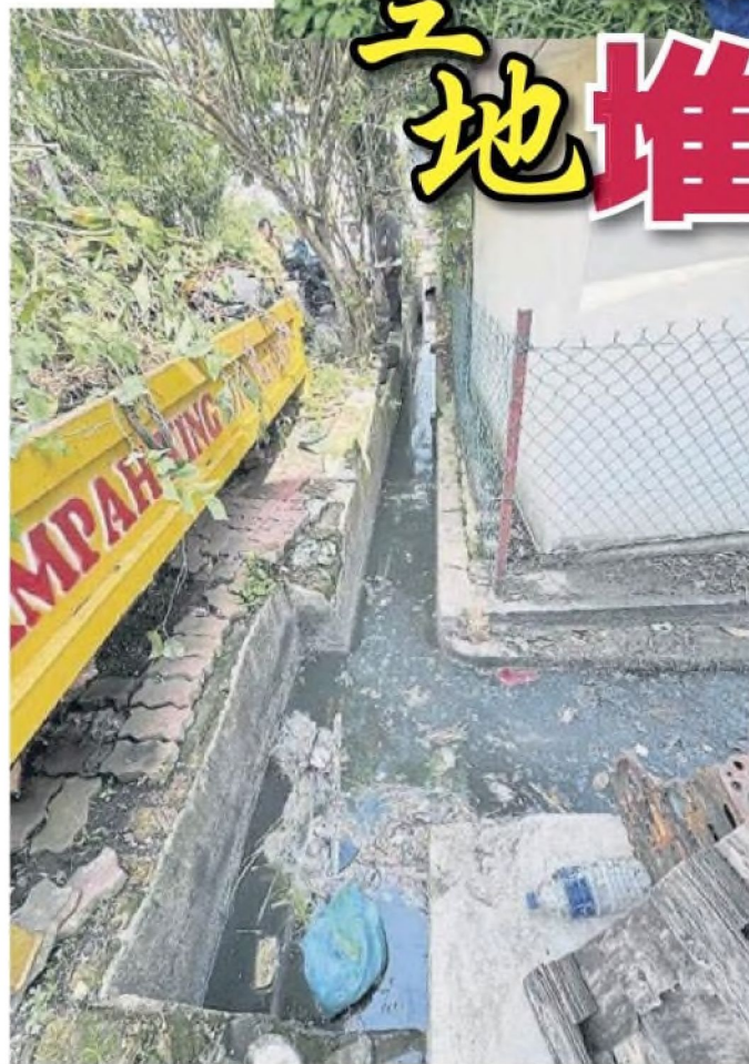
■增江新村沟渠堆满沉淀物，惟难以被清理。 (图由賴俊權提供)
