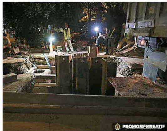
挖路工程照明不足也会被罚。（取自隆市局脸书）
