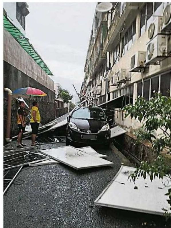
大风刮倒建筑结构，并坠落在道路上，也压毁停在底下的车辆。(民众提供)
