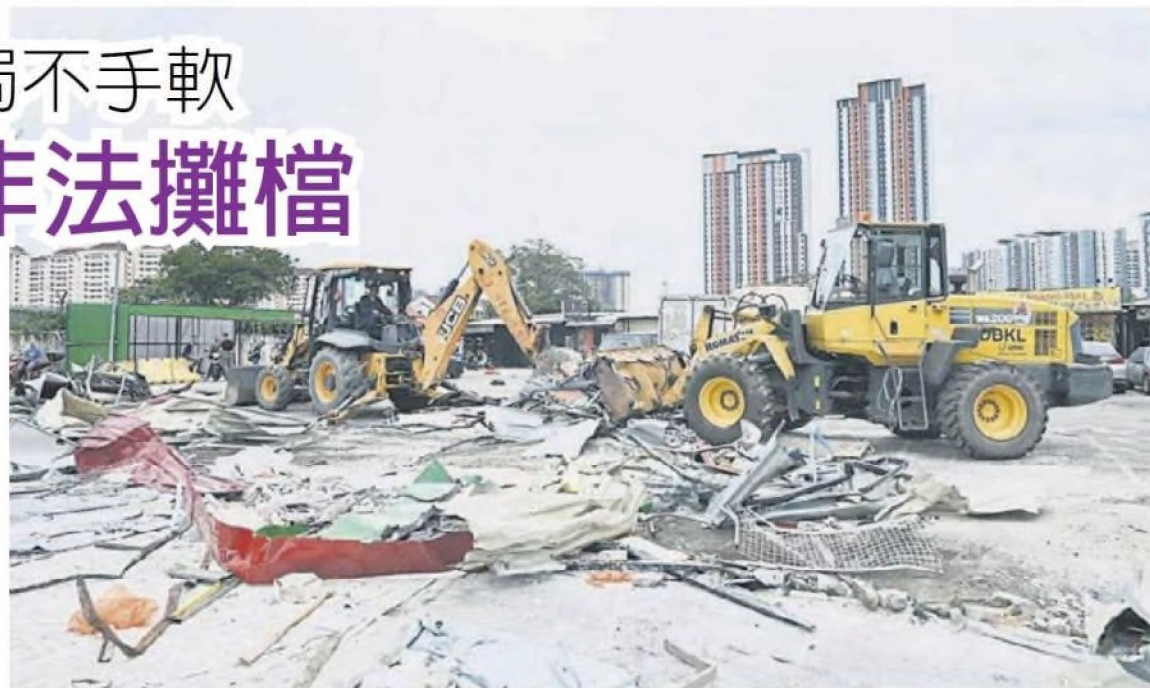
■ 被拆除的摊位中, 有25个已获得执照的摊位, 被市政局允许恢复。(图摘自面子书)
