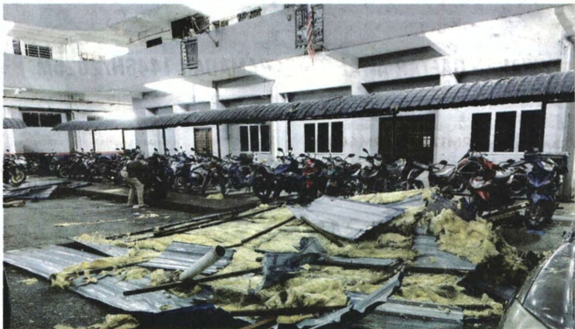
KEPINGAN bumbung yang tercabut sebelum terhempas di atas jalan akibat diterbangkan ribut dalam kejadian di Apartmen Putra Ria, Bangsar kelmarin.
