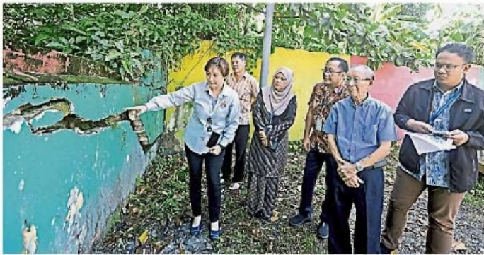
梁愛君(左一)向市政局官員展示圍牆的情況，除了牆體傾斜之外，牆面上也出現大片裂痕。左二及右二為陳紹球及葉志祥。
