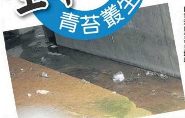
■青苔丛生，建筑也逐渐失色。 ■该河内外可见垃圾，
