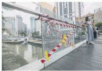
■存在安全隐患。 ■河道的管已用警戒线封闭，但仍
