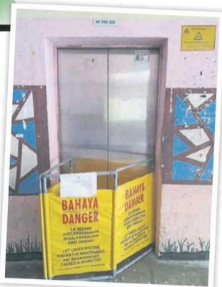
■常生活受到嚴重影響，居民常無法使用，日組屋的升降機頻發生故障。
