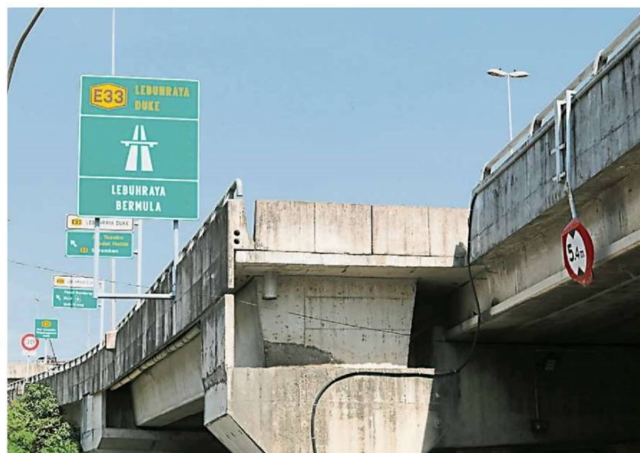
一半被搁置的天桥。(陈启基摄) 大使路—淡江大道的高架天桥旁,有一个兴建
