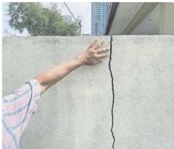
■民宅围墙出现裂痕。
