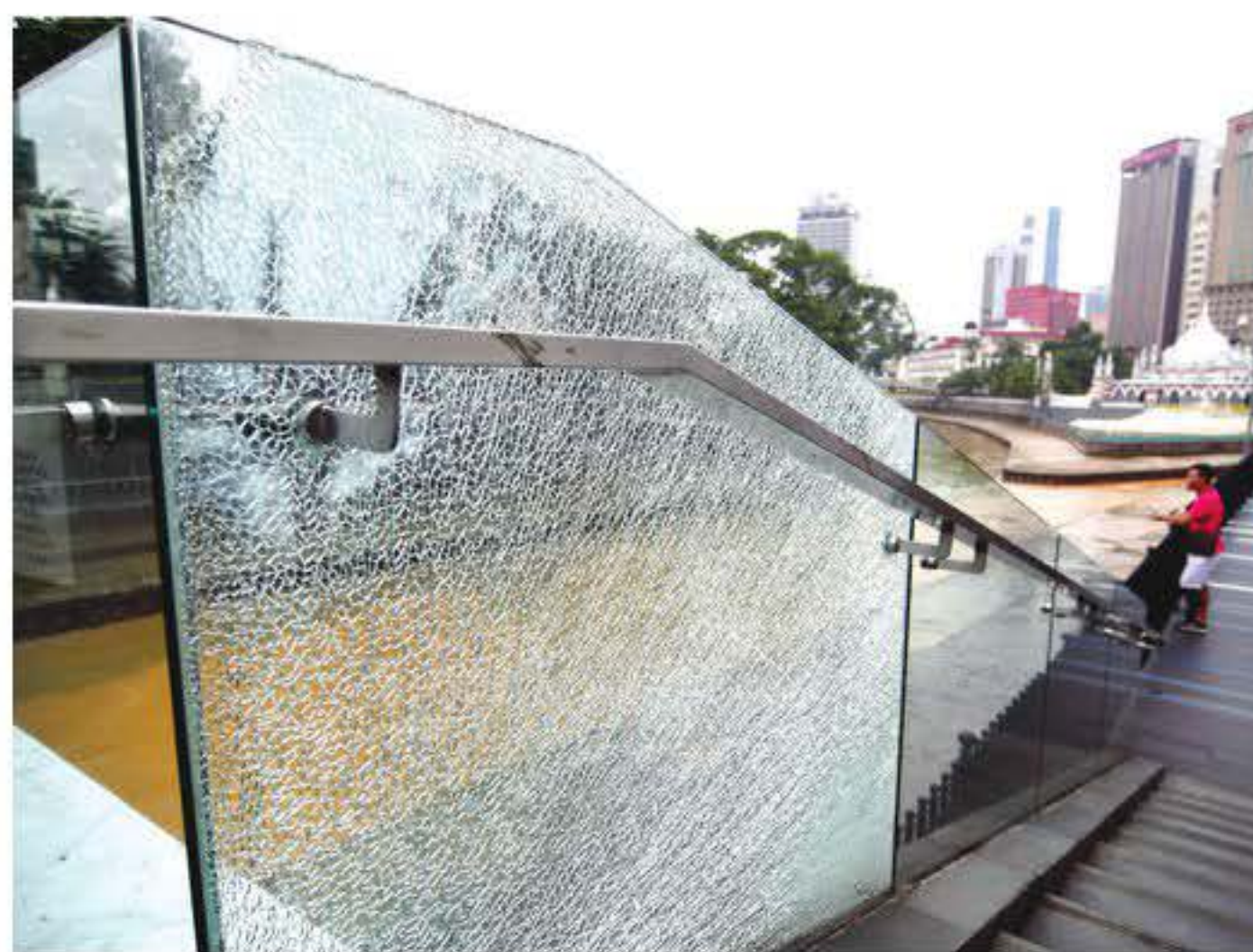
DINDING kaca di tebing Kolam Biru pecah akibat perbuatan vandalisme.
