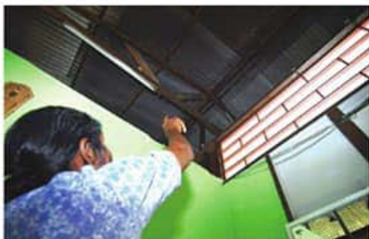
PENDUDUK menunjukkan bumbung rumahnya yang bocor setiap kali hujan.
