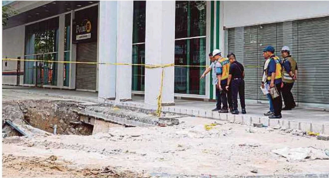
Anggota penguat kuasa DBKL meninjau lokasi sekitar insiden tanah jerlus di Jalan Masjid India, semalam.
