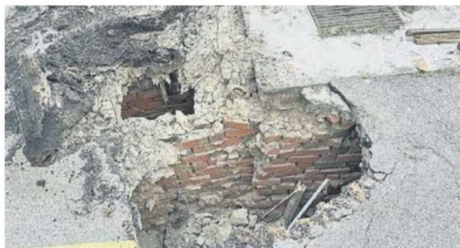
■增江北区斯迪亚7路地陷已遭市政局挖开检测，市政局或将于明日进行维修。(图由赖俊权提供)
