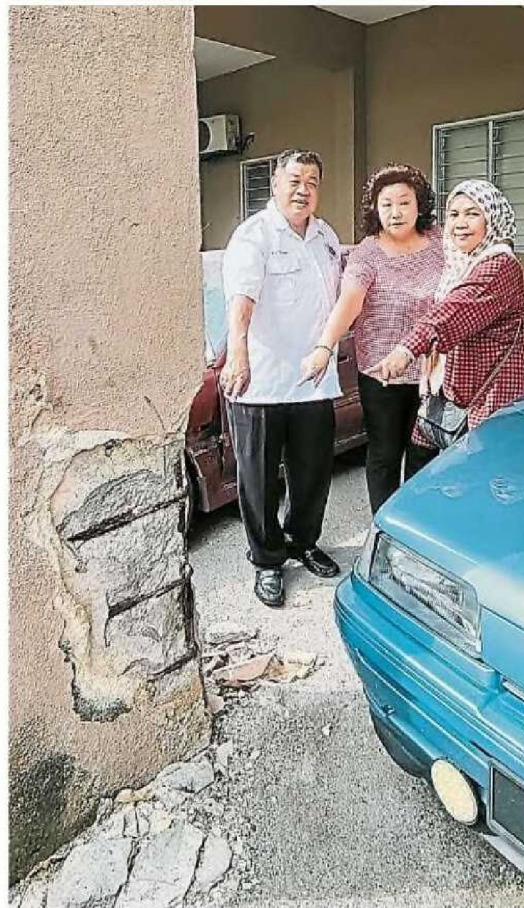
组屋底层主柱严重爆裂，露出钢筋水泥。曾国龙（左起）、余秀琼及努琳，促请隆市政局关注组屋结构的异常变化。（罗忆雯摄）
