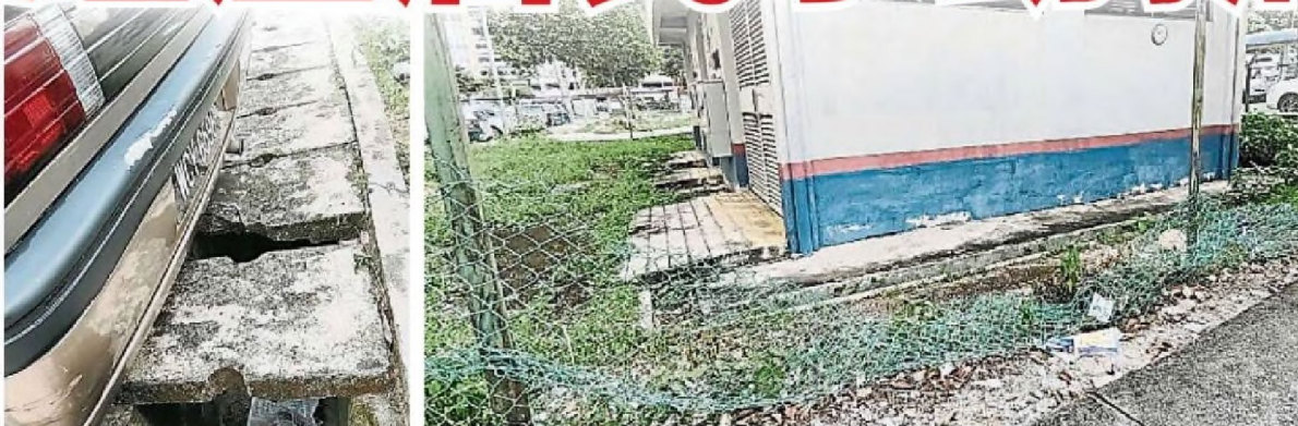
▲组屋的国能电房围篱破损已久，没人维修。（罗忆雯摄）
