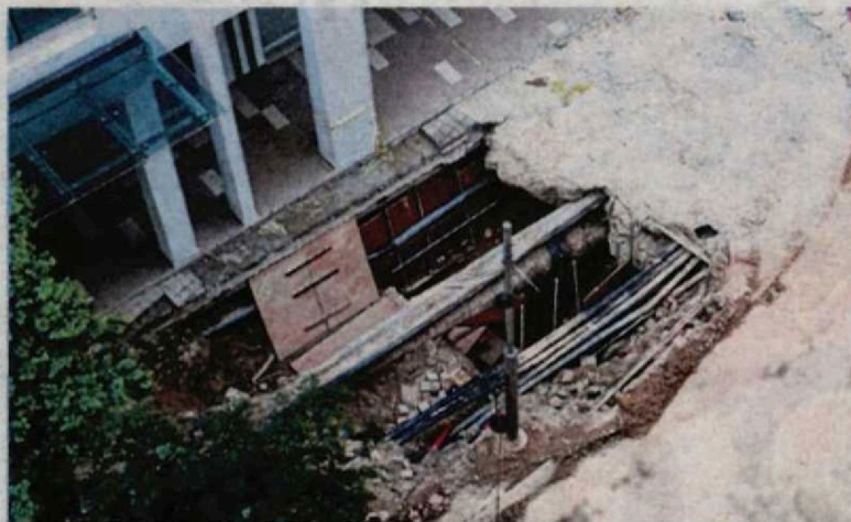
Kejadian tanah jertus di Jalan Masjid India, Kuala Lumpur 23 Ogos lalu.
