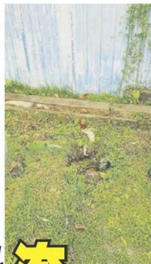
■排水沟塌陷，也导致排水沟上方向地陷，造成路面坑洞。
