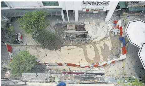
■印度清真寺路于8月发生地陷事故，目前该区域已被封锁，展开修复工程。
