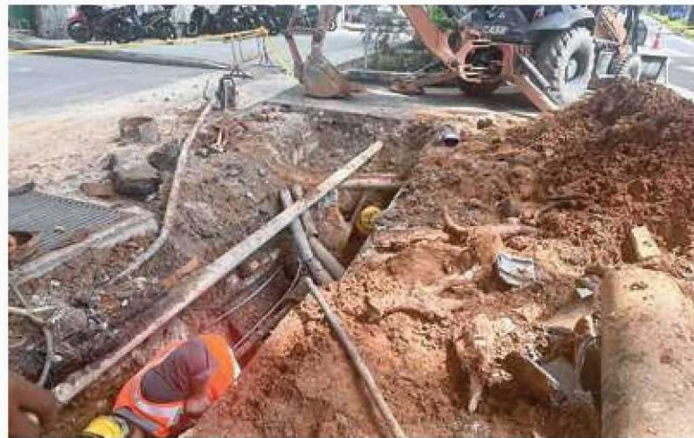
INSIDEN di Jalan Sultan Ismail disebabkan oleh kejadian paip pecah bukan mendapan tanah.
