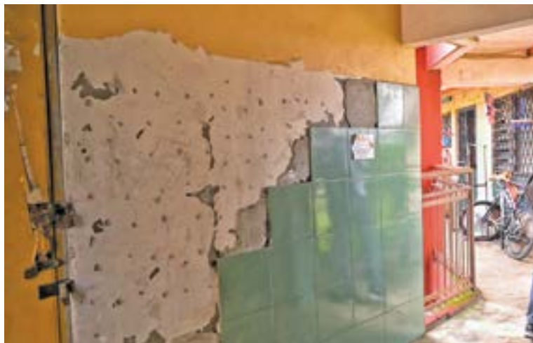
KEADAAN rumah yang telah uzur dan rosak memerlukan penyelenggaraan daripada pihak DBKL bagi memastikan keselamatan penghuni di sini.
