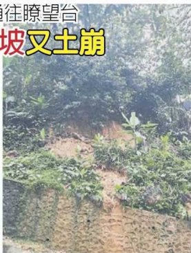
■斜坡开始出现泥土松驰的迹象, 故余保凭呼吁市政局“磨平”斜坡, 确保树木勿因为泥土松驰发生倒塌。(图由余保凭提供)
