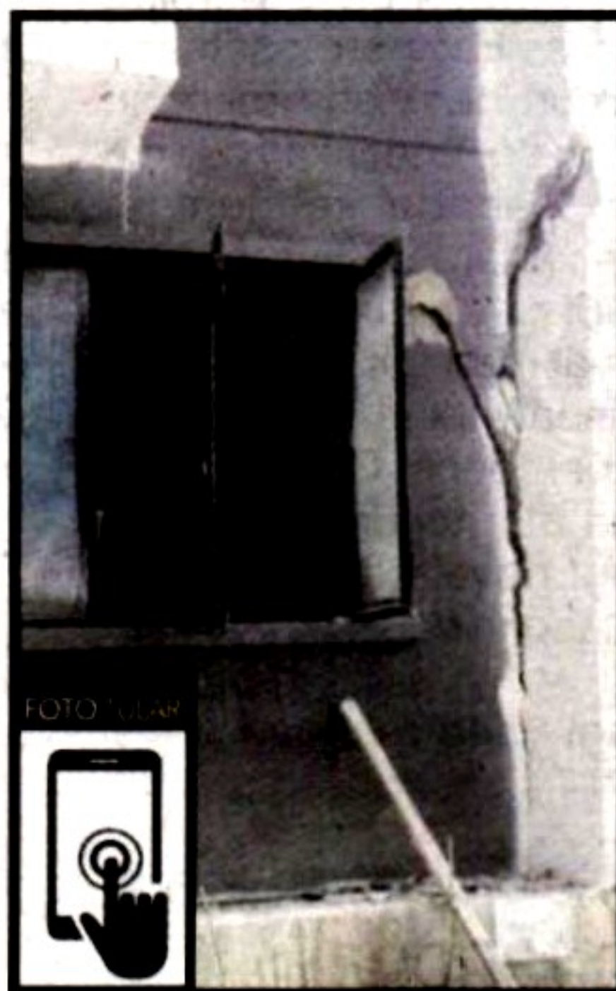
Gambar tular keretakan pada struktur bangunan tersebut.
