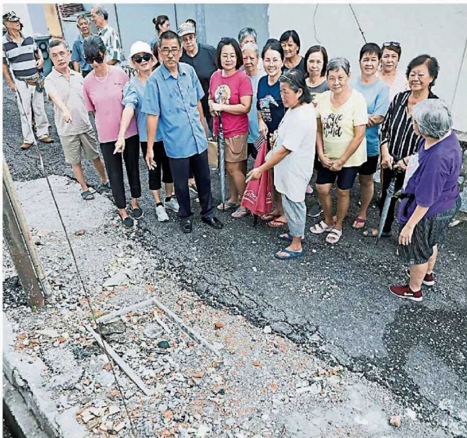
沟渠及马道路损坏及崩塌引起浪依淡路地区居民的担心，进而寻求余保凭的协助。图为当地居民带领余保凭（左四）前往巡视各个后巷的沟渠与马路损坏情况。（黄玲玲摄）
