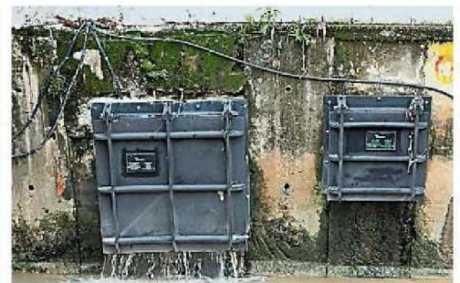
↑当局在多巴河安装防洪闸，避免河水溢满后流出路面。（谭湘璇摄）
