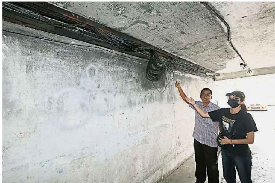
居民向余保凭（左）展示组屋电线因陈年失修而掉下的情况，担心将会带来危险。
