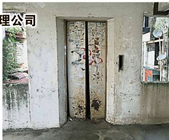
每一座组屋的电梯已损坏，居民被迫爬楼梯回家。
