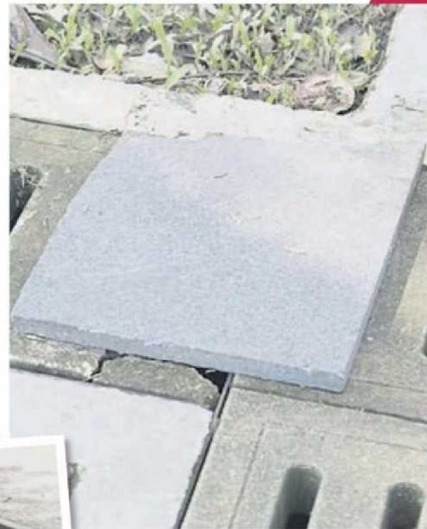
↑造成晨運客踩空跌傷的溝渠蓋，已被人放上磚塊遮住破洞。
