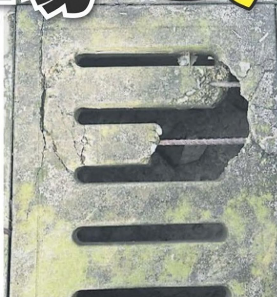
■大草場處損壞的溝渠蓋不只一個。
