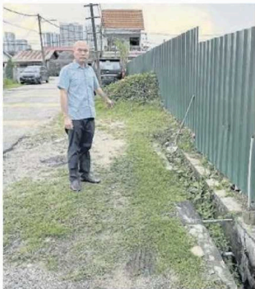
■林立迎巡视增江路士迪亞2路沟渠坍塌问题。
